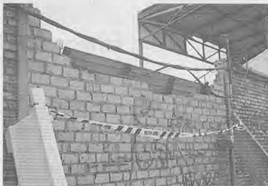
Estado en el que se encuentra una parte del muro de cerramiento del estadio. LVA
